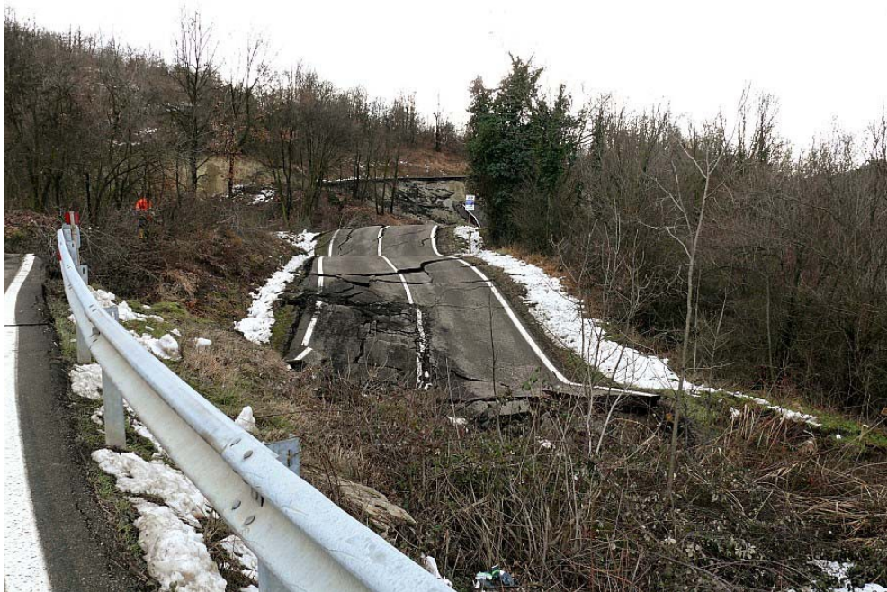
Fig 2.6: Comune di Guiglia dissesto della strada provinciale SP623 in seguito all'attivazione della frana nei giorni seguenti l'evento del 20-21 gennaio 2009 (cortesia ARPA-SIMC Emilia-Romagna).
