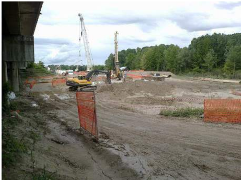
Figura 59 - Un cantiere per la realizzazione della terza corsia dell'autostrada A4 Torino-Trieste (foto di Davide Torassa).
