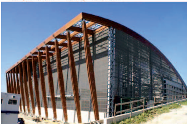
▲ Centrale di Gassificazione CDR - Roma - Italia
